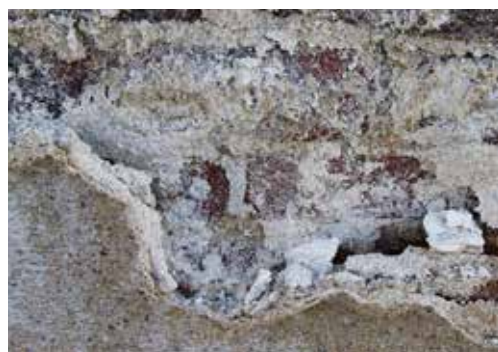
Tipično oštećenje eflorescencijom soli.
